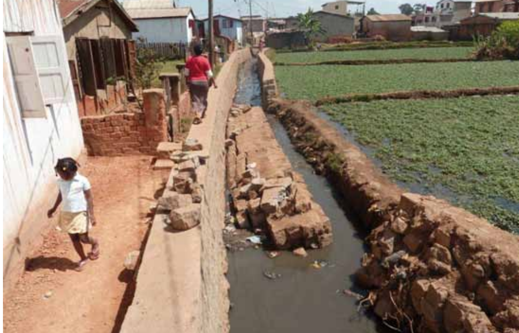
État fréquent des canaux des eaux usées à Antananarivo, Madagascar.
